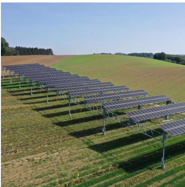
Abbildung 3: Pilotprojekt Agri-Photovoltaik-Anlage in Heggelbach am Bodensee. Bild: Fraunhofer ISE, https://www.ise.fraunhofer.de/de/leitthemen/integrierte-photovoltaik/agri-photovoltaik-agri-pv.html (08.04.2022)
